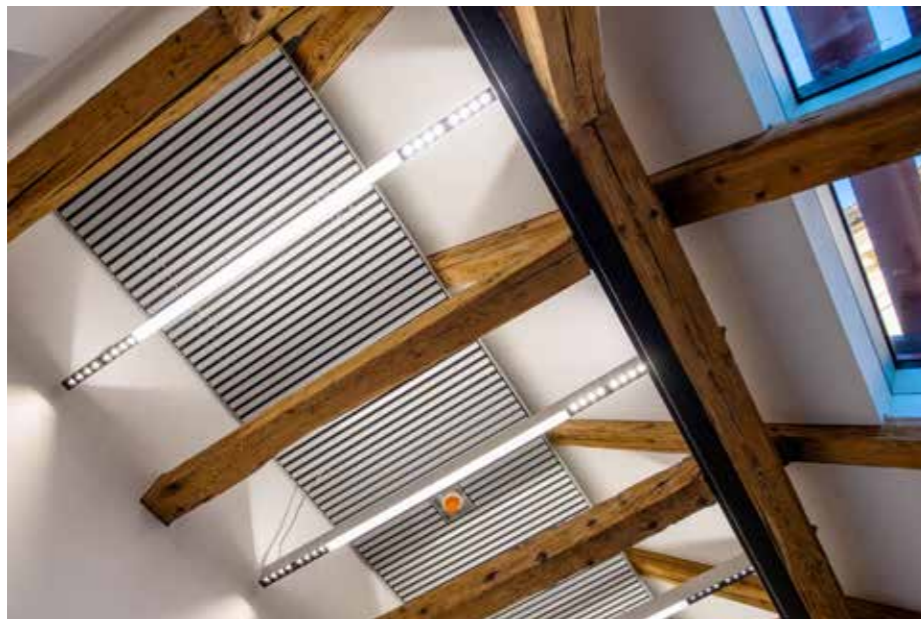
> Designový lamelový podhled a nad ním funkční podhled v stísněném prostoru po celém 4. patře
