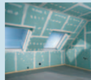
Zatmelené opláštění podkroví
