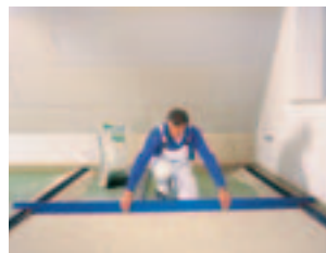
...srovnáte podsyp. Vrstvy suchého podsypu Knauf tloušťky 5 až 10 cm je třeba ztuhnout.
